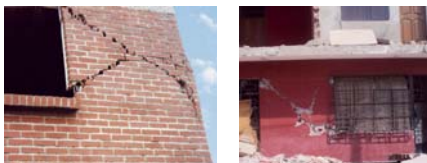
Fig. 3. Falla por fuerza cortante en muros cortos sin confinamientos en los extremos.
